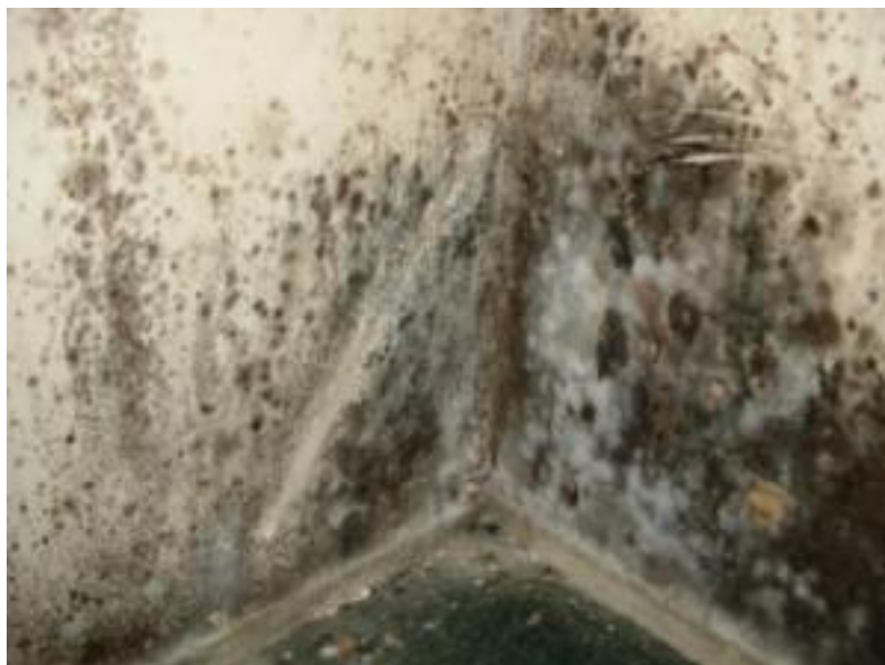
Εικόνα 3. Μούχλα σε τοίχο. Πηγή: https://i1.wp.cpm/www.viewdeco.gr/wp-content/uploads/2012/12/wall-mold.jpg?resize=300%2C224
